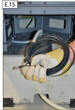
E.15 Die im LEDA LUC Grafikdisplay werkseitig vorinstallierte Datenbusleitung (Gesamtlänge 15 m zum LEDA LUC Grafikdisplay) befindet sich im Öffnungsbereich der Zuluftöffnung der Brennkammer.
