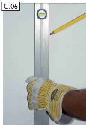
Bauseitige Öffnung aus der Leichtbauwand im Bereich der Sockelleiste bzw. des Rohfußbodens festlegen.
