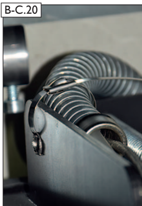
B-C.20 Eine entsprechende Bohrung ist hierzu an einem Metallsteg an der Brennkammer vorhanden.
