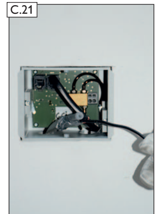
... LEDA LUC Bedien- und Messeinheit verlegen.
