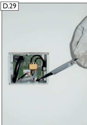
Mit bauseitigem Zugdraht nun vom bauseitigen Elektroverteiler das Datenbuskabel zur LEDA LUC Bedien- und Messeinheit ziehen.
